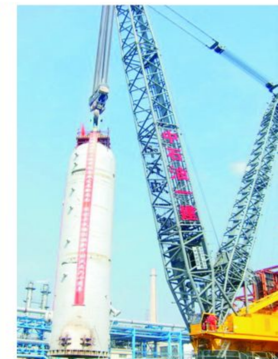
加氢反应器 Hydrogenation reactor
